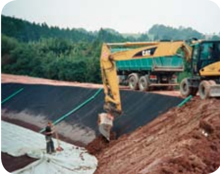
Klärschlammvererdungsanlage Enkamat 7010W/80.30PP Speicher, Deutschland
