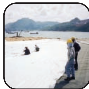
TKO, Hong Kong Drainage des eaux en décharge
